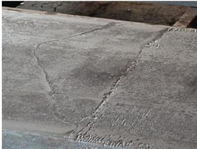
Figura 2. Foto ilustrativa mostrando o defeito na placa ocasionado por sticker .
